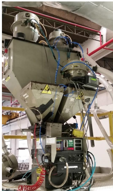
Figura A.2 – Sistema de dosagem (Conair) instalado no ativo.
