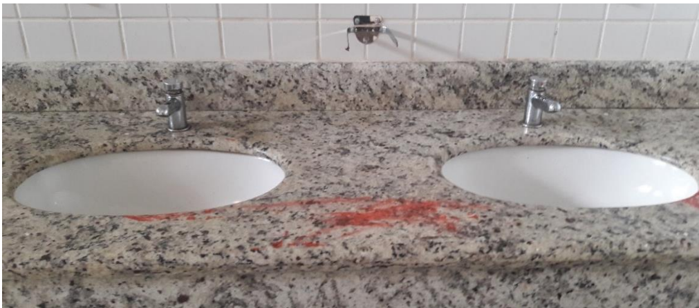
Figura 15 - Torneiras com sensor no banheiro do bloco do curso de Pedagogia
