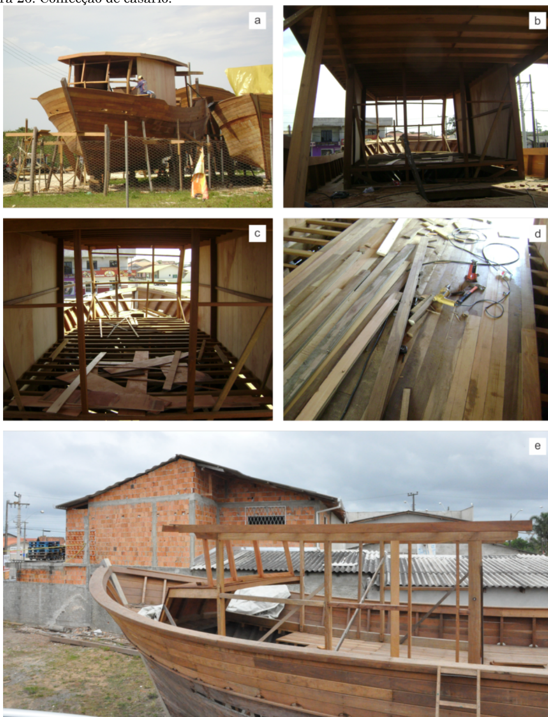
Estrutura (a); piso elevado (b); vista interna (c); colocação do assoalho (d) e vista geral (e).
