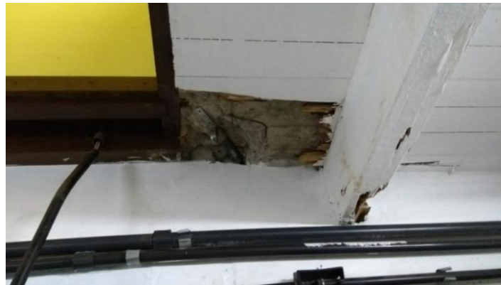
Imagem 5 - Rachaduras e espaços abertos nas vigas de madeira do teto.
