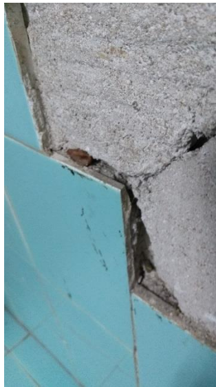
Imagem 3 - Rachaduras no reboco.
