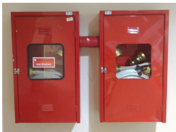
FIGURA 1: Mangueiras de incêndio
