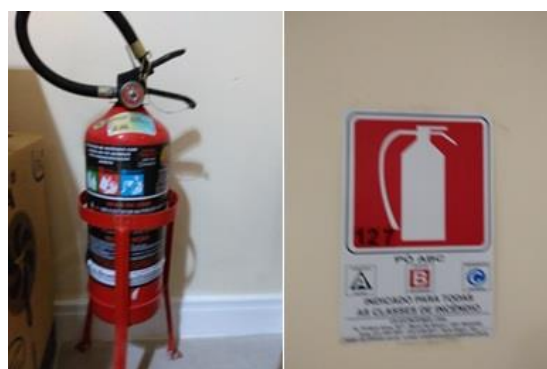
FIGURA 2: Pó químico contra incêndio
