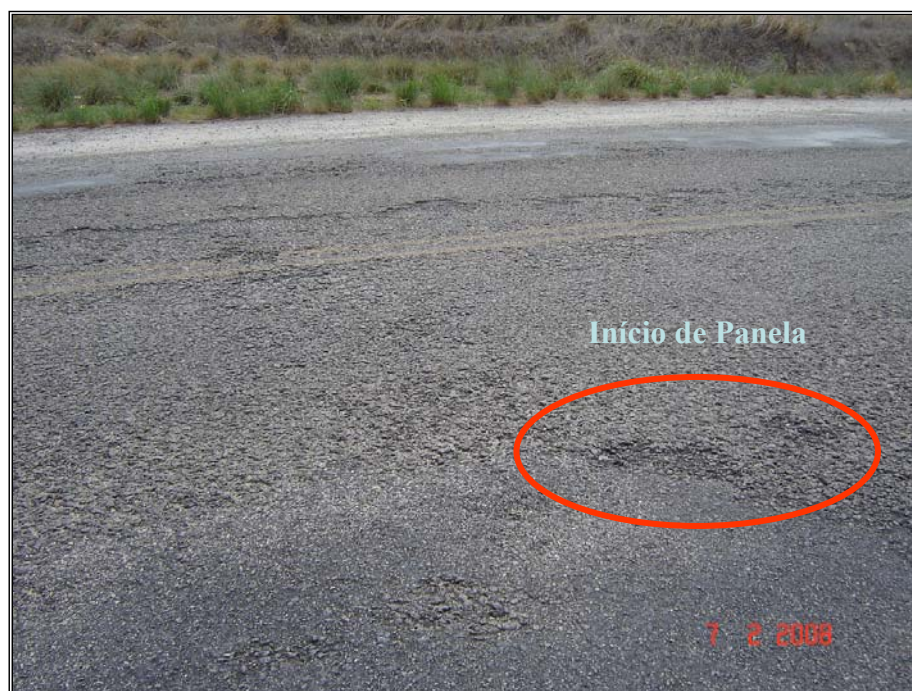
Figura 50: Desgaste em TSD oxidado no km 1+500 da PB-054.
