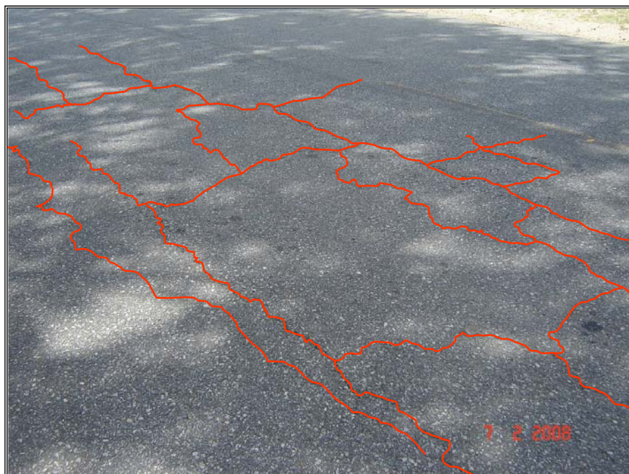
Figura 49: Trincamento de bloco, não associado às cargas de tráfego, no km 1+600 da PB-079 (revestimento em CBUQ).
