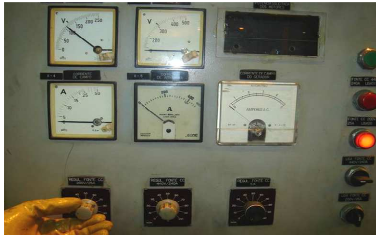
Figura 4.6 - Painel elétrico do laboratório de testes
