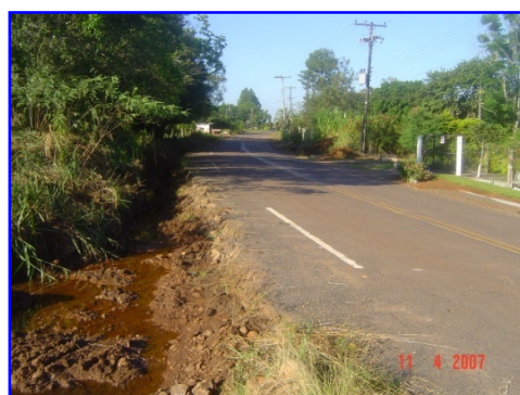
Figura.16 : Drenagem deficiente (RSC 129, Km 23+150 em 2007) Fonte: Couto (2007, acervo do autor).
