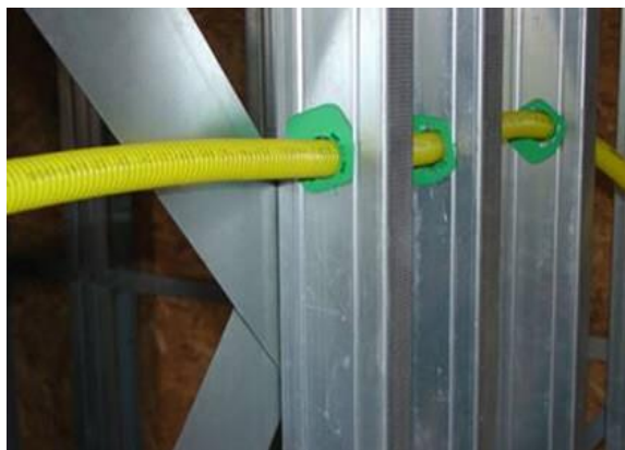
Figura 1.4 – Detalhe da passagem de dutos através dos furos nos montante metálicos (FLASAN, 2016)
