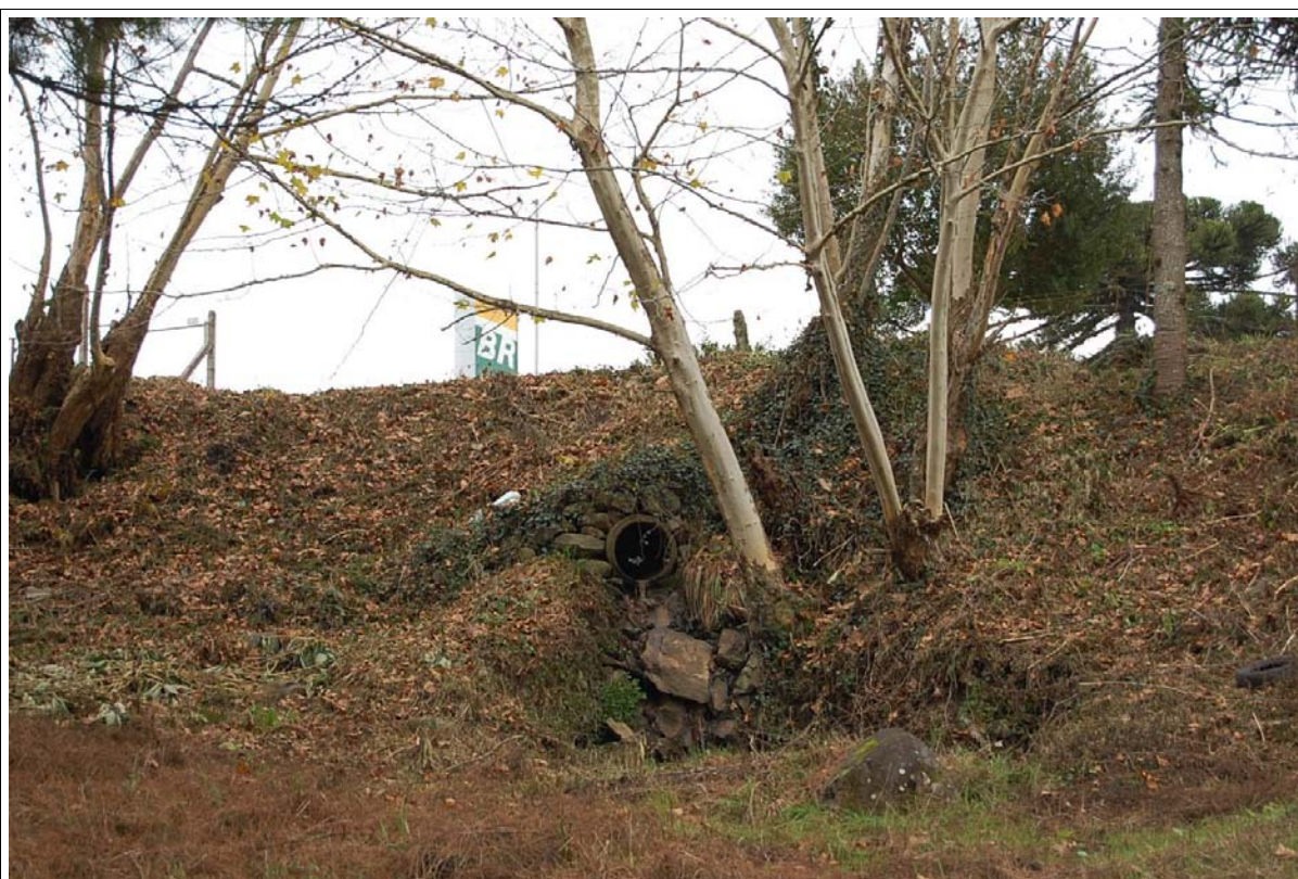
Figura 16: Posto de Gasolina no topo do morro, e esgoto pluvial (Ponto 1). Data: 07/06/2008
