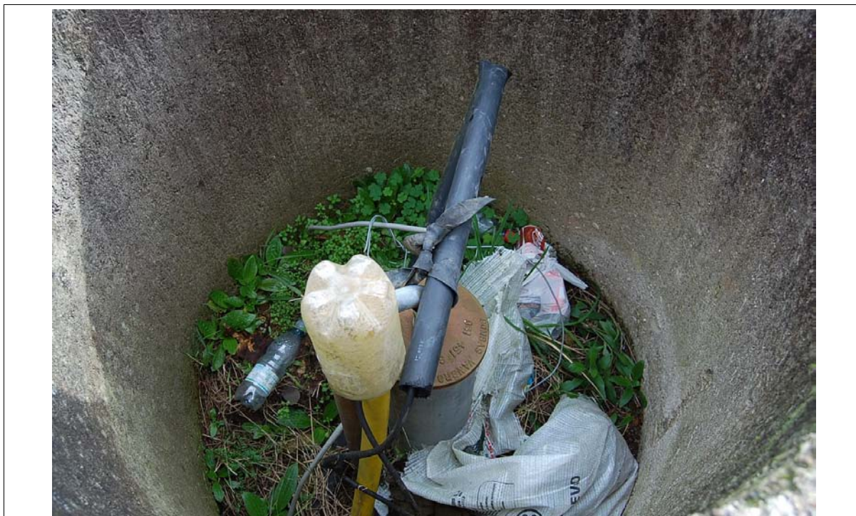
Figura 38: Acúmulo de lixo junto à bomba de captação de água no posto de gasolina (Ponto 9). Data: 07/06/2008
