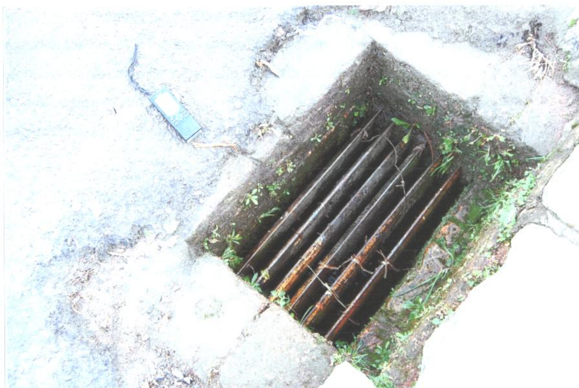
Figura 12: Bueiro de captação de esgoto pluvial com água canalizada da nascente (Ponto 9) Data: 07/06/2008
