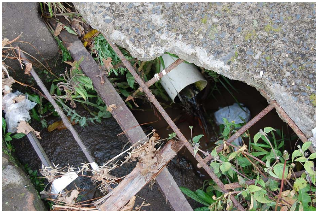
Figura 15: Água da nascente em bueiro de esgotamento pluvial. (Ponto não cartografado) Data: 07/06/2008
