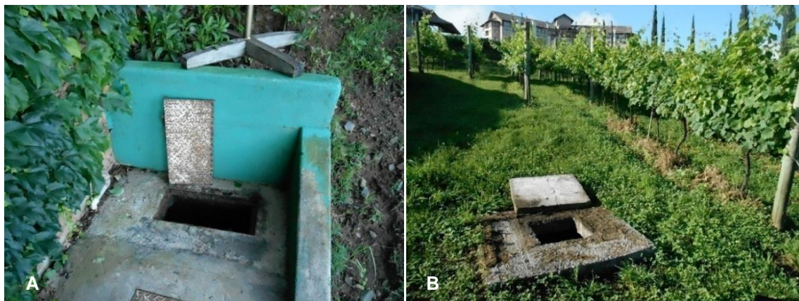
Figura 13. (A) Caixa de gordura. Coleta do efluente bruto. (B) Coleta na saída do efluente tratado. Fonte: Autora.
