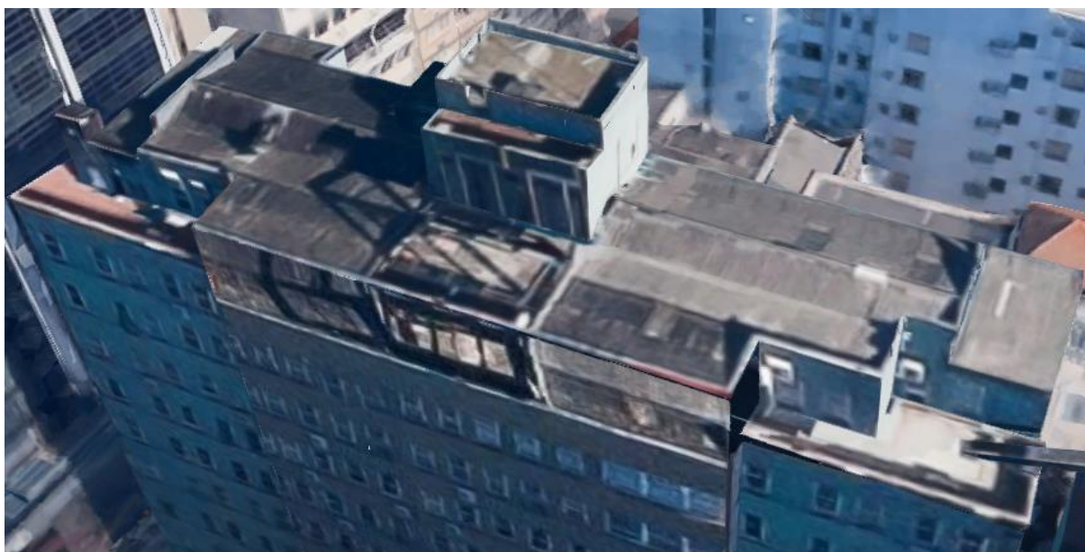
Figura 29 – Vista aérea da cobertura do edifício sem espaço para reservatório de combate à incêndio
