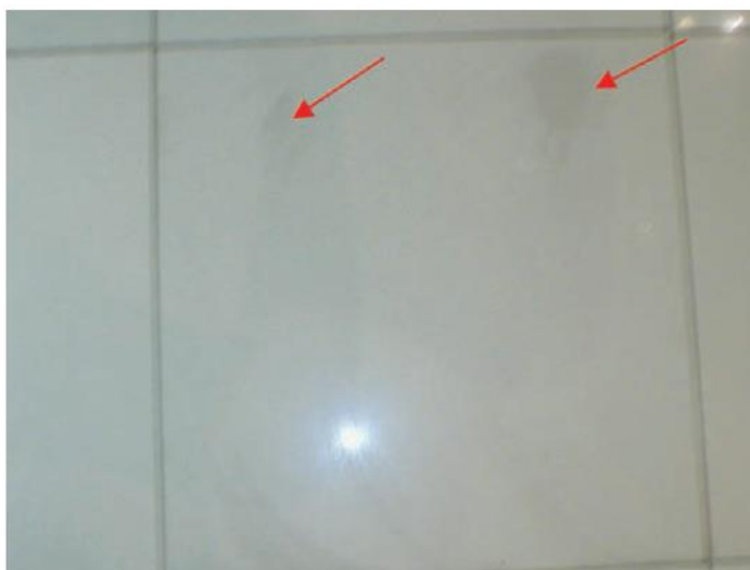
Figura 9 – Manchamento em piso revestido com porcelanato
