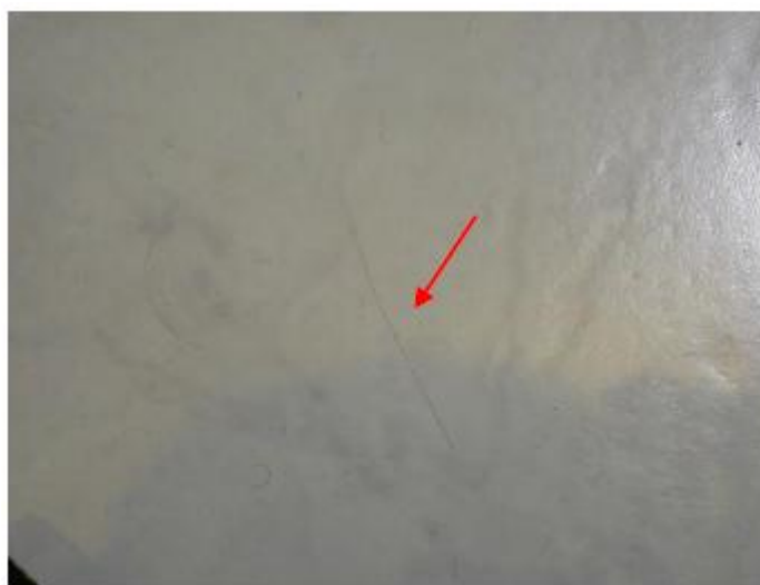
Figura 5 – Riscamento em revestimento de piso com porcelanato
