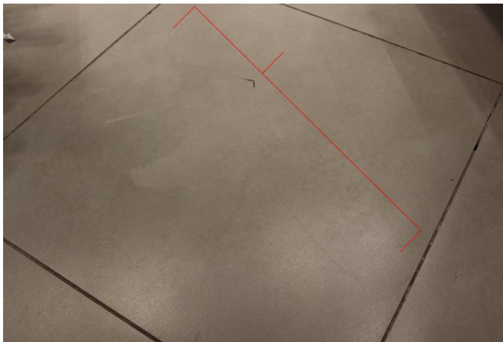
Figura 26 – Ruptura longitudinal em revestimento de piso com porcelanato natural liso na loja 8
