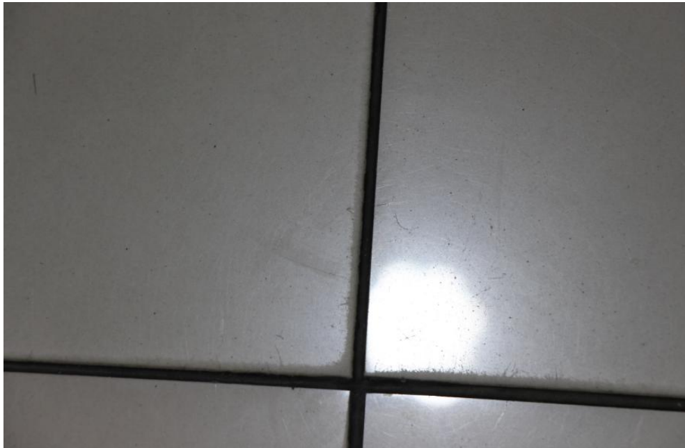
Figura 21 – Desgaste em piso revestido com porcelanato polido na loja 26
