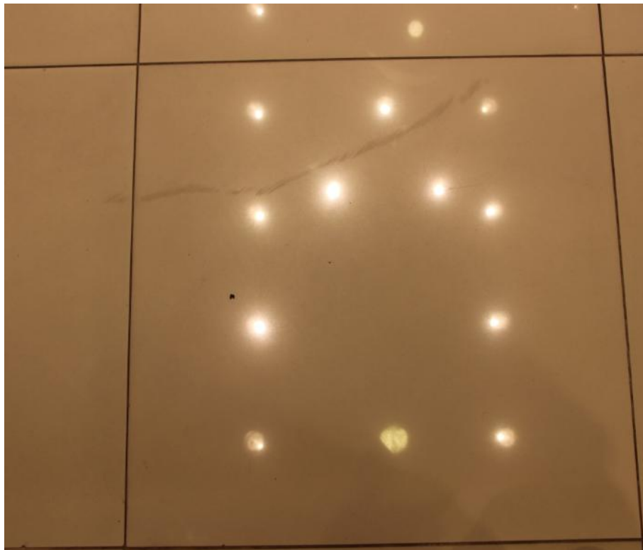
Figura 22 – Manchamento em revestimento de piso com porcelanato polido na loja 12
