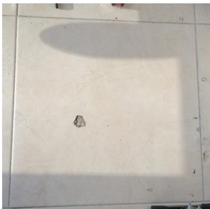
Figura 14 – Lascamento em revestimento de piso com porcelanato
