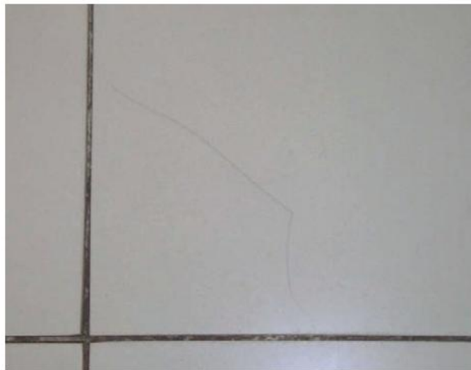
Figura 12 – Ruptura de canto em piso revestido com porcelanato
