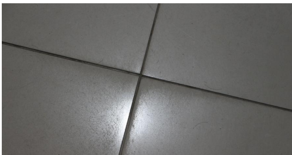
Figura 20 – Desgaste em piso revestido com porcelanato polido na loja 33
