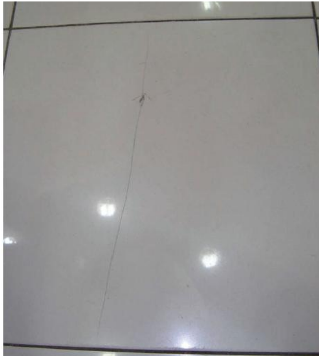
Figura 11 – Lascamento com ruptura longitudinal em piso revestido com porcelanato
