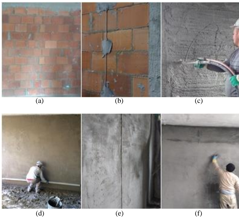
Figura 21 - Etapas da execução do revestimento interno com projeção. (a) parede a ser revestida; (b) posicionamento das taliscas/mestras; (c) projeção de argamassa; (d) sarrafeamento; (e) remoção das barras de referência; (f) desempenho
