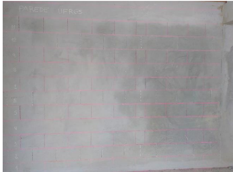
Figura 22 - Aspecto da parede cujo revestimento foi executado com argamassa projetada, evidenciando as juntas de assentamento marcadas.
