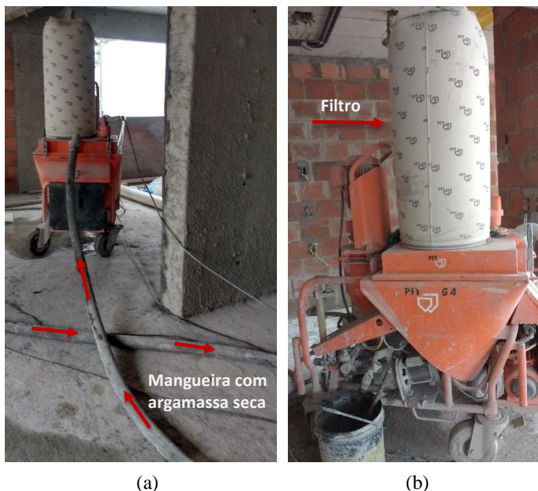
Figura 13 – Equipamento de projeção contínua. (a) Mangueiras transportando o material seco até a misturadora; (b) Filtro para redução da pressão na entrada de argamassa.
