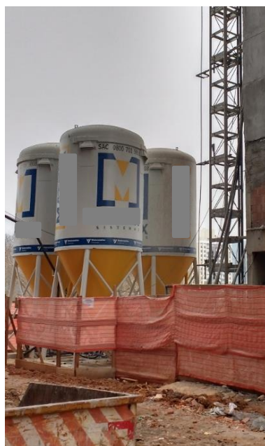
Figura 11 – Silos para armazenamento da argamassa de projeção e múltiplo uso
