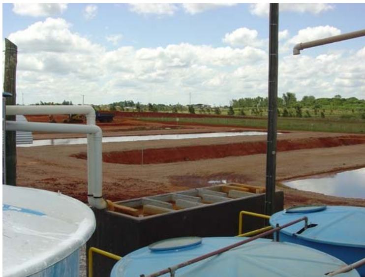
Figura 3. Bacias de sedimentação de flocos de DAM tratada (NF) e detalhe do sistema de floculação (chicanas de fluxo hidráulico horizontal) – Capão da Roça, COPELMI/RS
