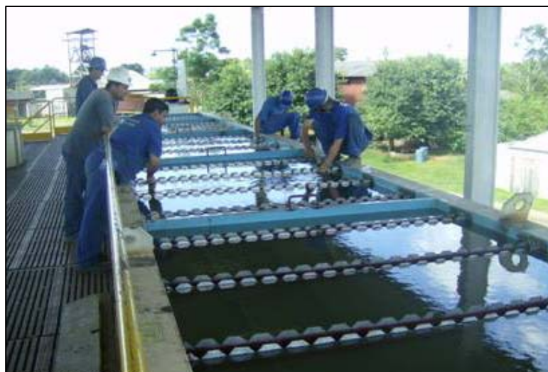
Figura 7. Estação de tratamento de DAM ( 250 \text{ m}^3 \cdot \text{h}^{-1} ) instalada na carbonífera Cooperminas
