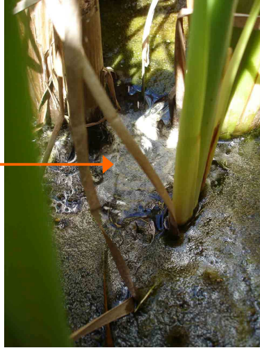
Figura 74. Precipitado de carbonato na entrada das caixas aeróbicas.
