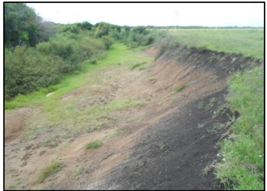
Fig. 7. Arroio Touro-passo: erosão.
