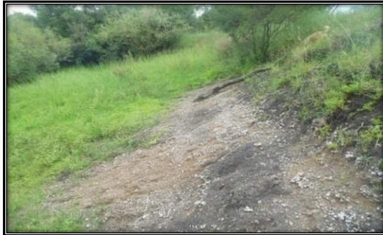
Fig.59. RS I – 67 rampa de erosão. Gomes.
