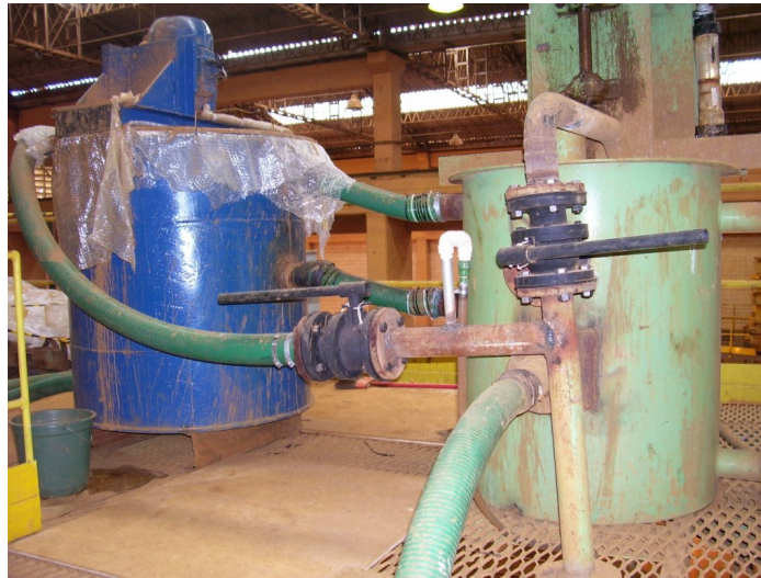
Figura 30. Válvulas para introdução/retirada do tanque CAI no sistema de flotação.
