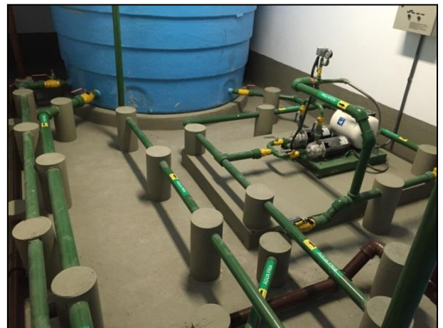
Figura 12 – Tubulações pintadas e sentido do fluxo de água indicado por adesivos
