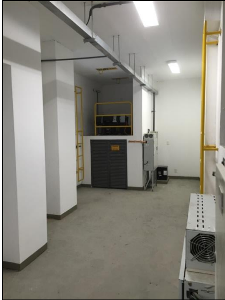
Figura 9 – Sala técnica de máquinas com padronização na pintura de escadas, piso, parede e teto
