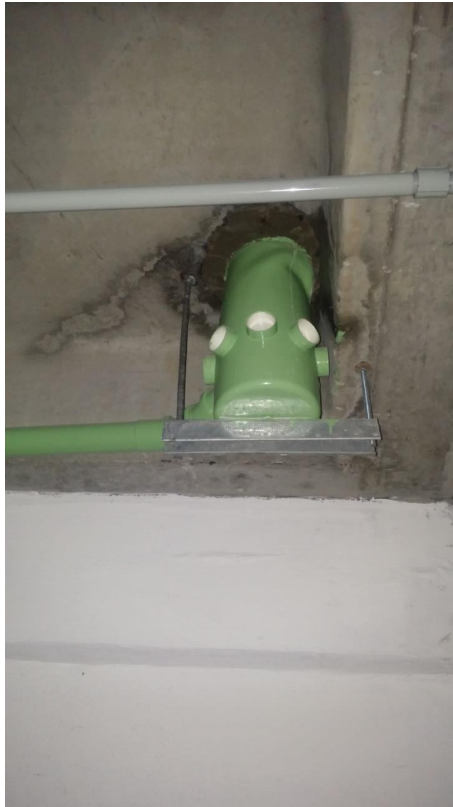
Figura 12 – Problema na vedação do ralo
