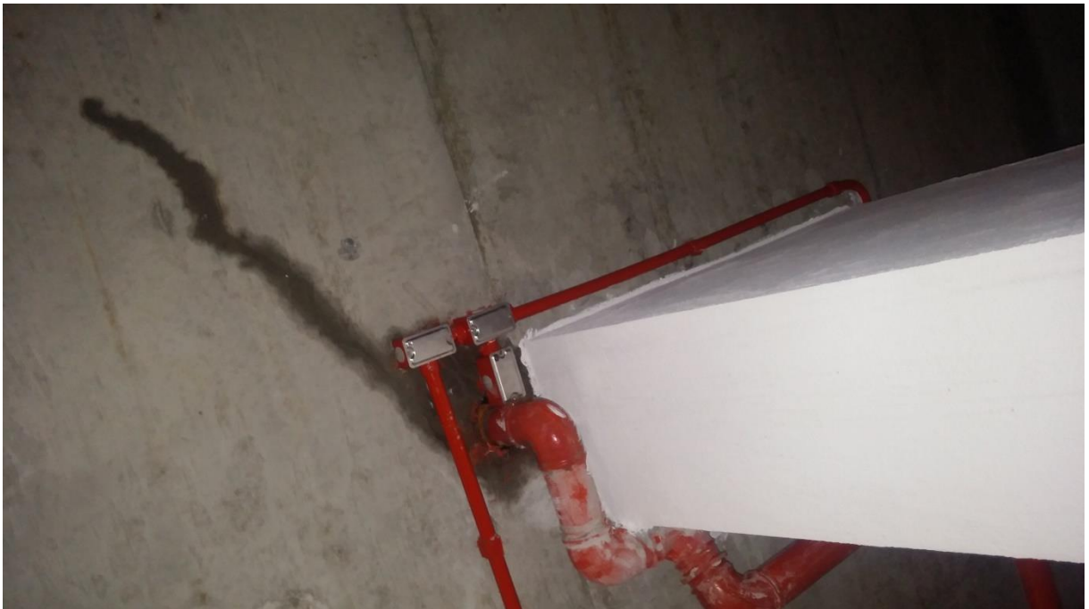
Figura 11 – Infiltração junto á tubulação de incêndio
