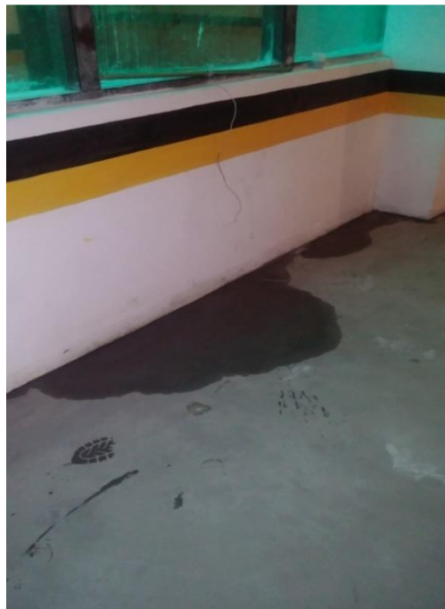
Figura 17 – Problema no rodapé junto à marquise
