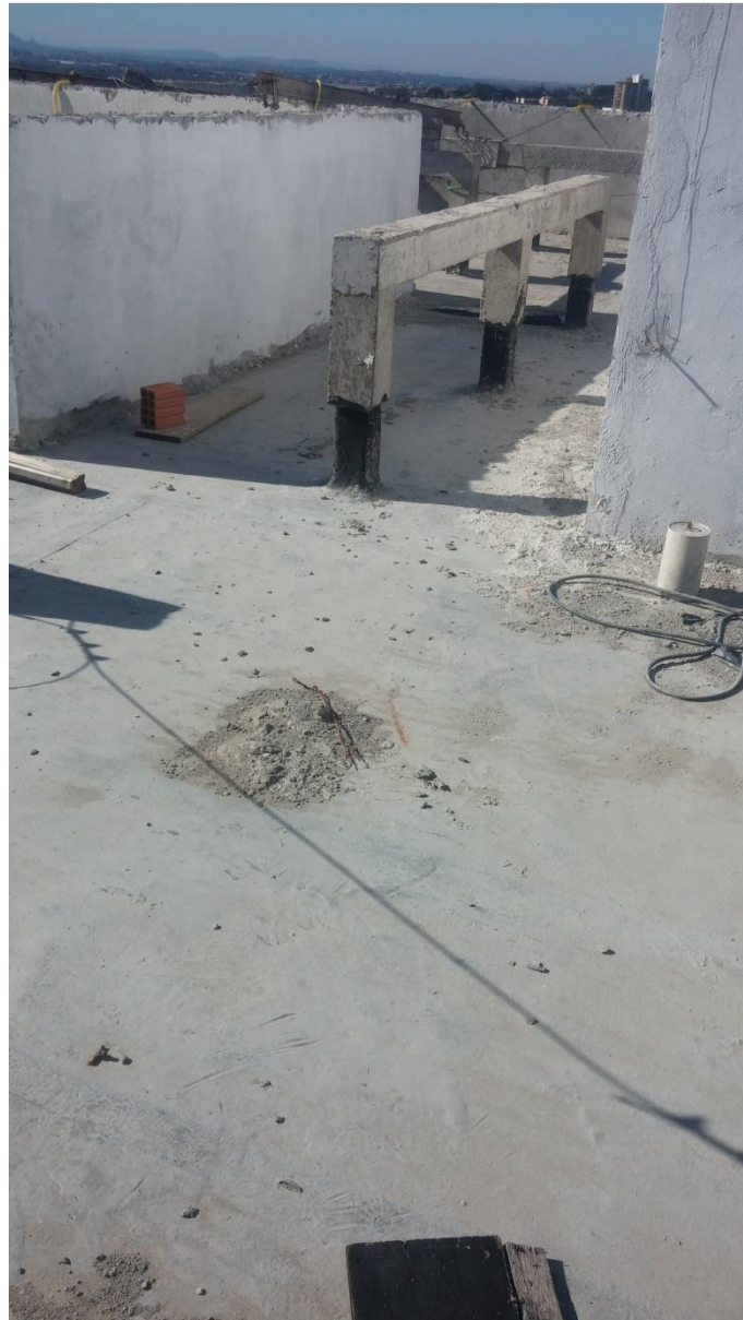
Figura 14 – Manta asfáltica liberada para tráfego sem a proteção mecânica
