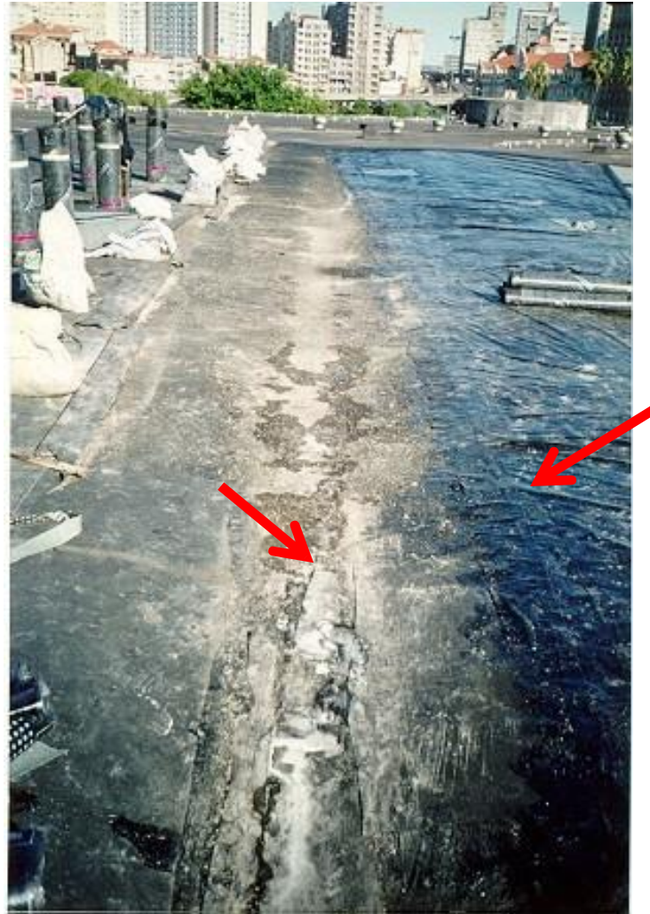
Figura 13 – Problema de transpasse em manta asfáltica
