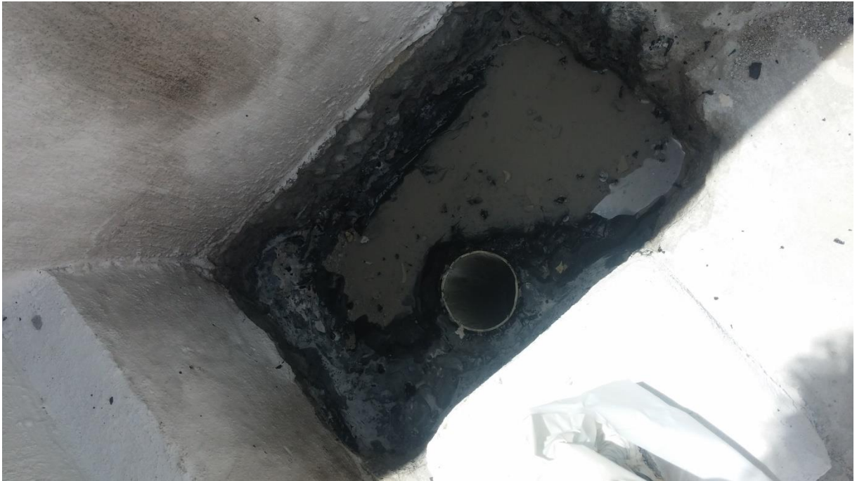
Figura 15 – Retrabalho devido à falta de engaste da manta no interior do ralo
