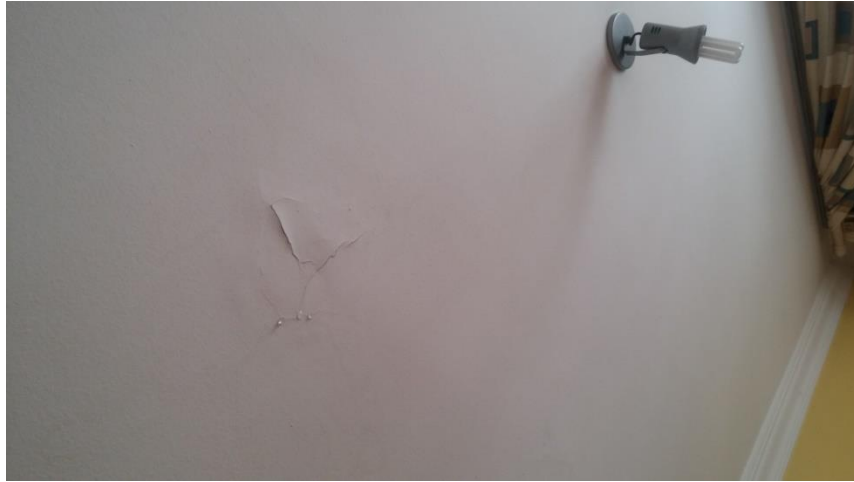
Figura 16 – Descolamento da pintura devido a infiltração
