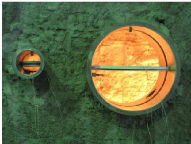
Figura 24 – Registro corta-fogo em parede de compartimentação
