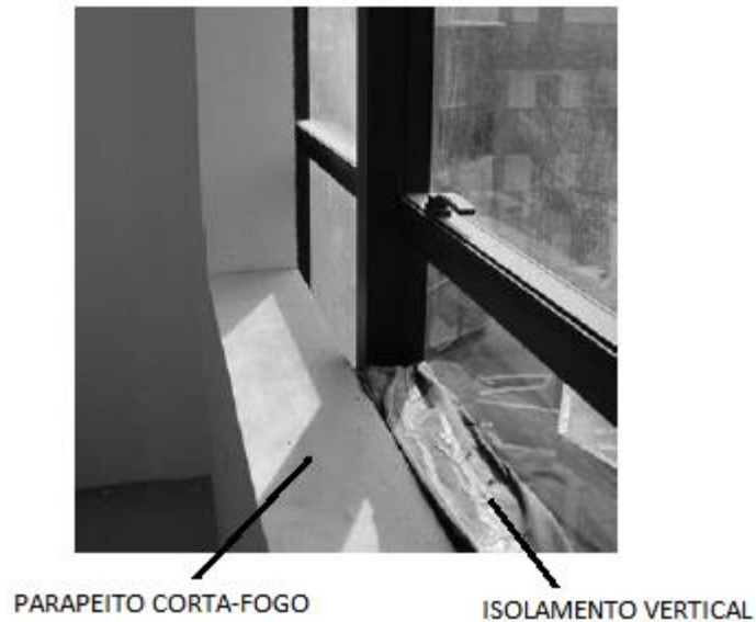
Figura 30– Proteção do espaço entre a estrutura da edificação e a pele de vidro
