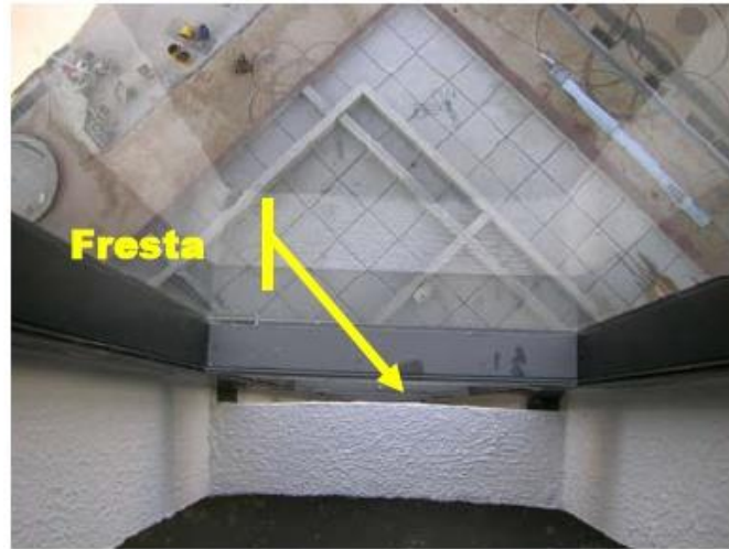
Figura 12 – Fresta entre a estrutura de esquadrias e a supraestrutura do edifício
