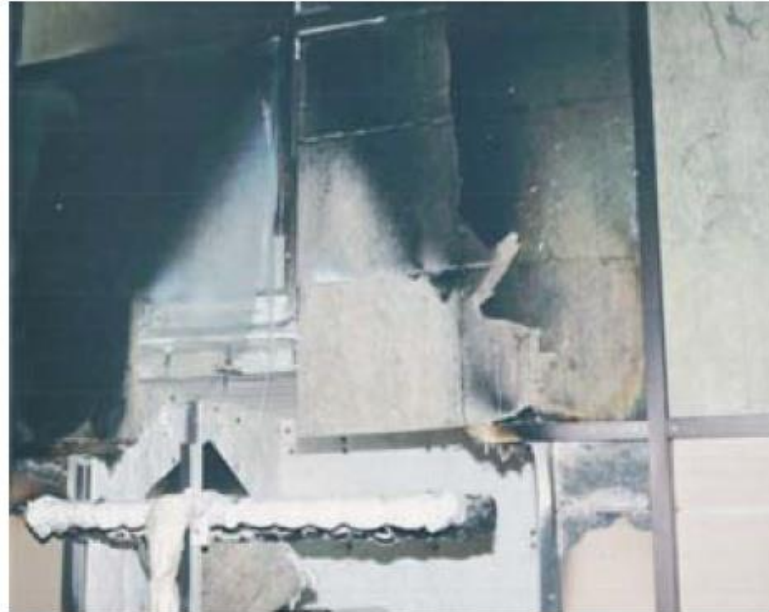
Figura 38 – Colapso do isolamento de lã de rocha adjacente à barreira periférica contra fogo
