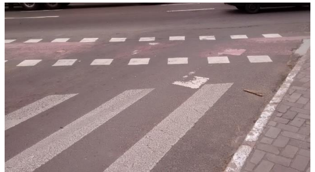
Figura 22: EEEF Rio de Janeiro ó Ciclofaixa em mau estado de conservação
