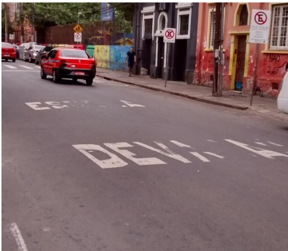
Figura 20: EEEF Rio de Janeiro ó Sinalização Horizontal de õESCOLAö e õDEVAGARö em mau estado de conservação
