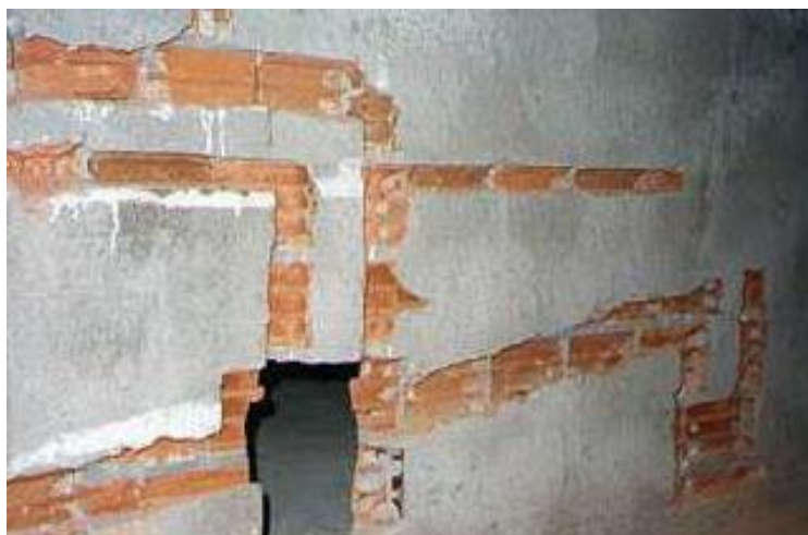
Figura 20 - Rasgos nas paredes construídas em alvenaria de vedação
