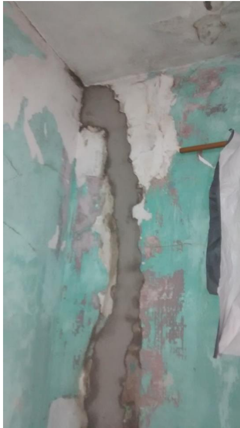
Figura 32 – Fissura interna com reparo efetuado
