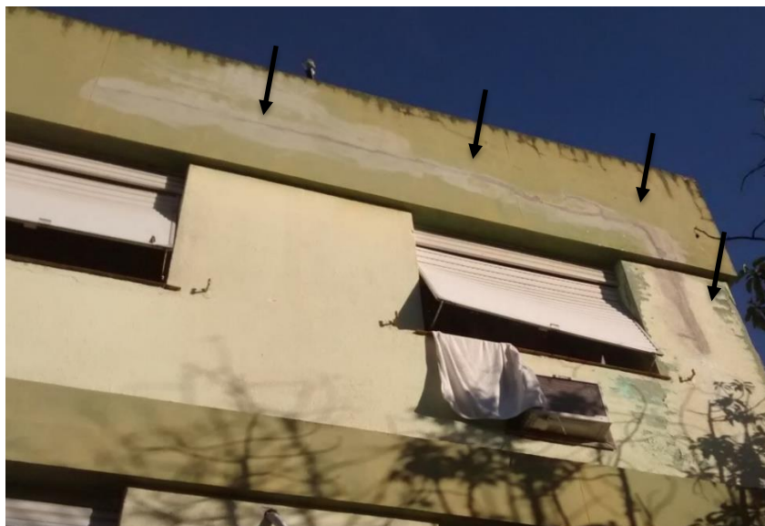
Figura 33 – Fissura externa com reparo efetuado
