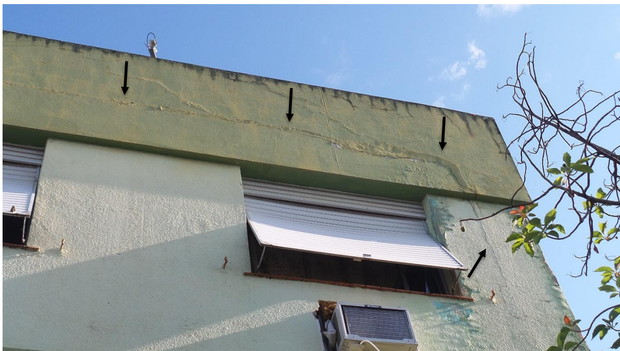
Figura 25 – Parede externa e platibanda fissuradas
