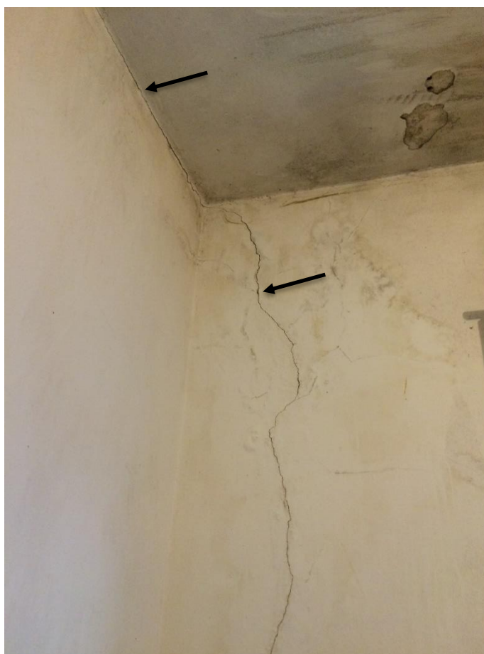
Figura 26 – Parede interna fissurada
