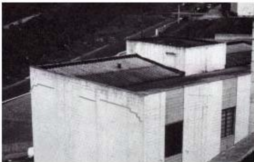
Figura 30 – Fissuras inclinadas no topo da parede (em ambas as extremidades) e destacamento da platibanda causados por movimentações térmicas
