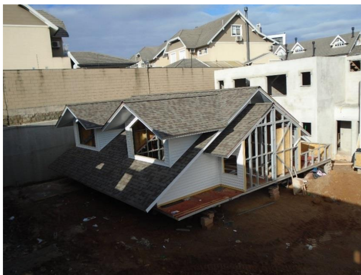
Figura 25 – Sótão sem vedação lateral
