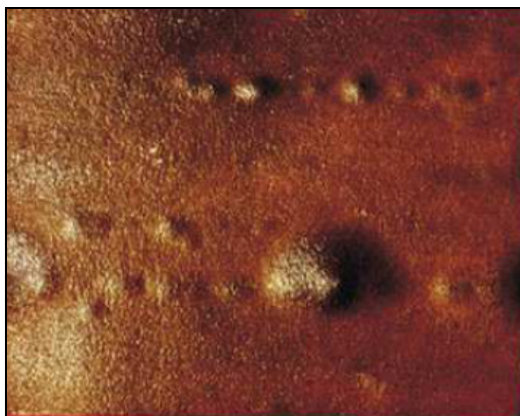
Figura 3-4 – Bolhas na superfície de uma chapa de aço causadas por empolamentos (GENTIL, 2011).
