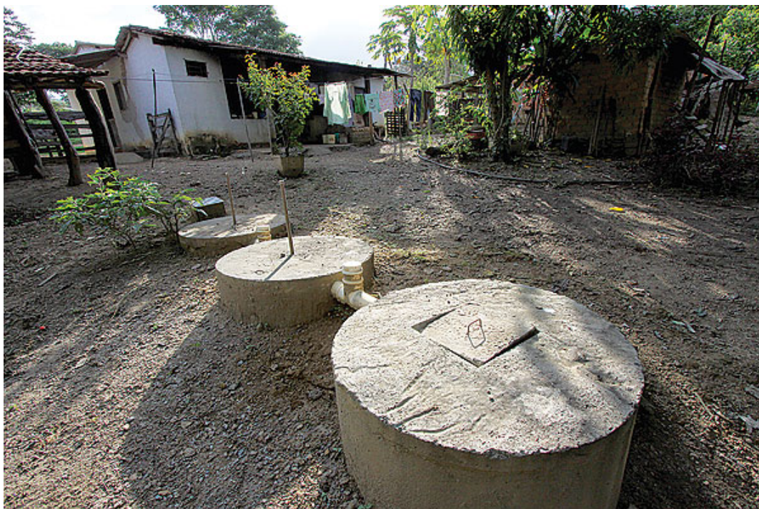
Figura 17: Conjunto de fossa séptica no meio rural.
