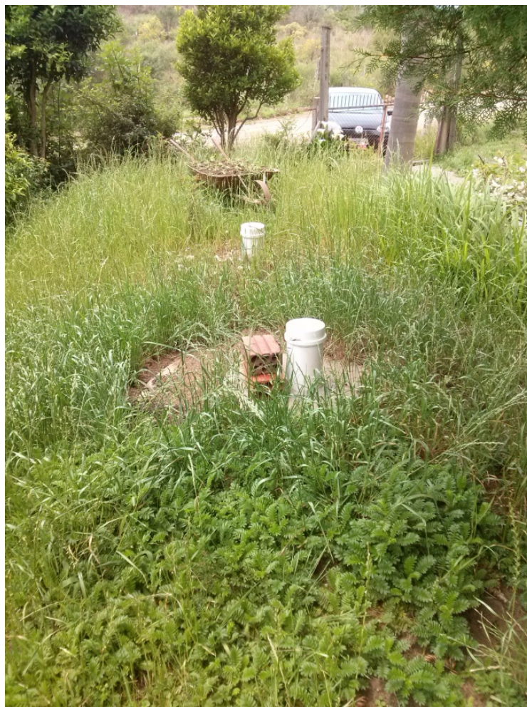
Figura 35: Conjunto de tratamento de esgoto doméstico em área rural. Foto: Sara Fernandes Borth, 2014.
