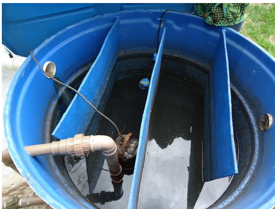
Figura 4.4: Sistema de desinfecção da ETE Litoral Norte, mostrando as chicanas para aumentar o tempo de residência do efluente.
