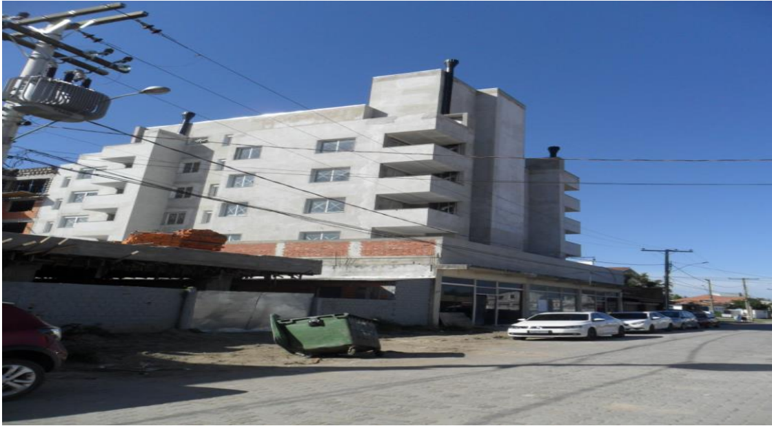
Figura 18: Prédio em construção na Rua Henrique Bule, esquina com a Av. Rio Grande. Foto: A autora
