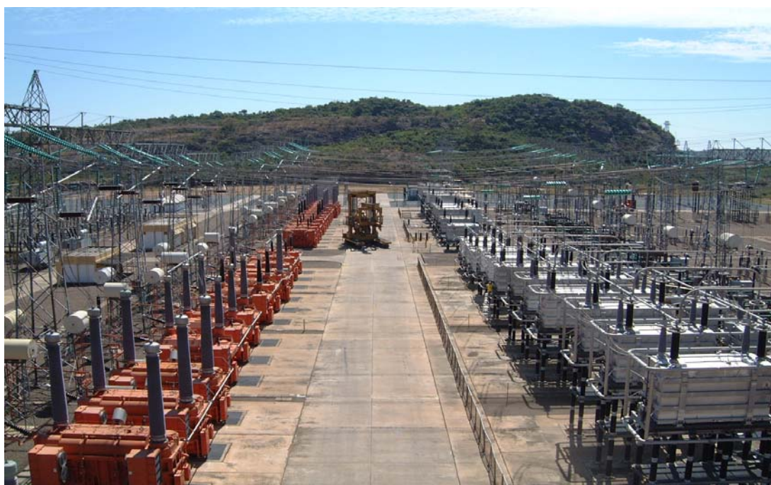
Foto 5: Subestação de Songo alimentada pela energia da Barragem de Cahora Bassa Foto: Hidroelétrica de Cahora Bassa, 2008 Pesquisa: MUNGOI, 2008
