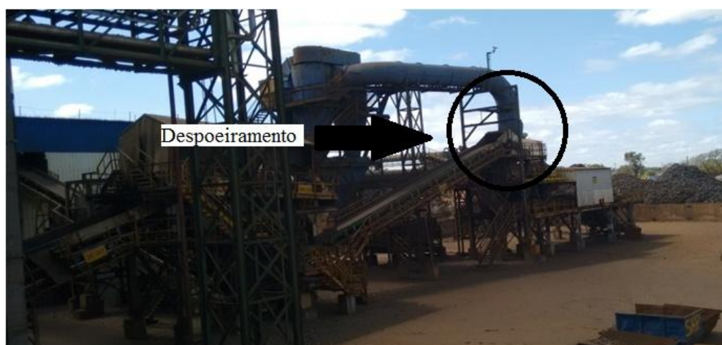
Figura 3.14 Localização do sistema de despoeiramento. Fonte: Cortesia Gerdau.
