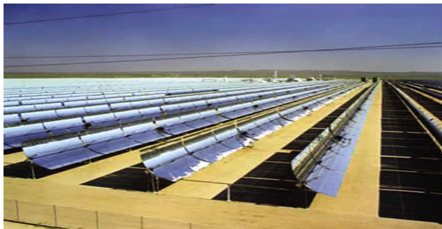
Figura 37 - Sistema térmico de geração solar de energia elétrica (Califórnia – EUA) Fonte: ANEEL (2002, online ).
