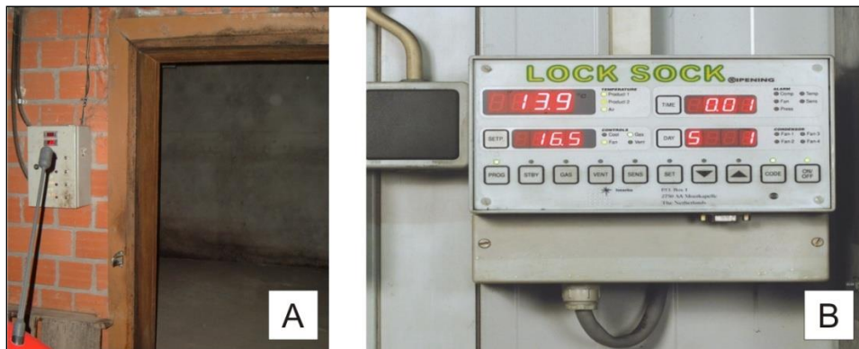
Figura 25 – Painel de controle de uma câmara de amadurecimento.
