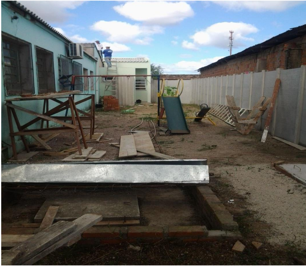
Figura 2 – Pracinha da escola desativada com entulhos da reforma
