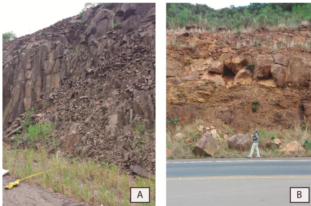
Figura 10: (A) queda no talude direito com a trena medindo a vala de contenção; (B) queda de grandes blocos no talude direito com porção central alterada (quadrado vermelho)
