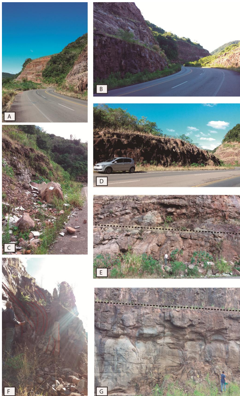
Figura 9: (A) visão do segmento S14 com orientação sul; (B) visão do segmento S14 com orientação norte, mostrando as curvas; (C) blocos caídos na porção antes da primeira curva; (D) talude direito; (E) trecho depois da primeira curva com rompimento em cunha (F) parte final do segmento com porção com intensa alteração e presença de fraturas paralelas a face do talude; (G) visão geral da parte final do segmento apresentando intensa alteração. As linhas tracejadas são referentes ao limite de derrames
