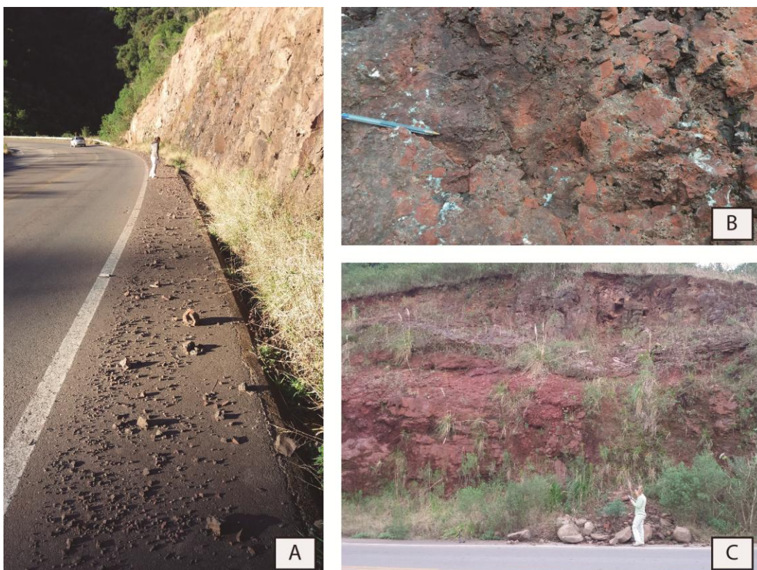
Figura 12: (A) início do segmento com vala de 0,5m e diversos fragmentos de rocha na estrada; (B) porção brechada in situ ; (C) foco de quedas na porção final do segmento
