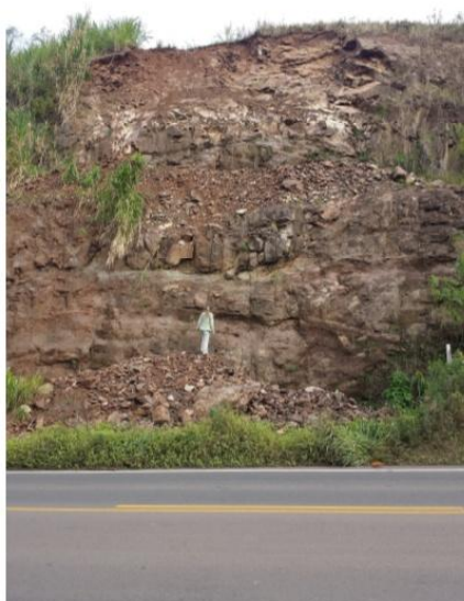
Figura 5: visão mais crítica do talude, mostrando o patamar e a vala preenchidos por blocos
