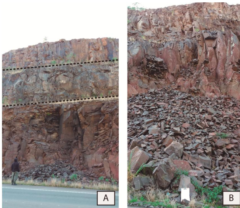
Figura 13: (A) visão da altura do talude com as linhas pontilhadas marcando os patamares; (B) mostra o maior foco de queda
