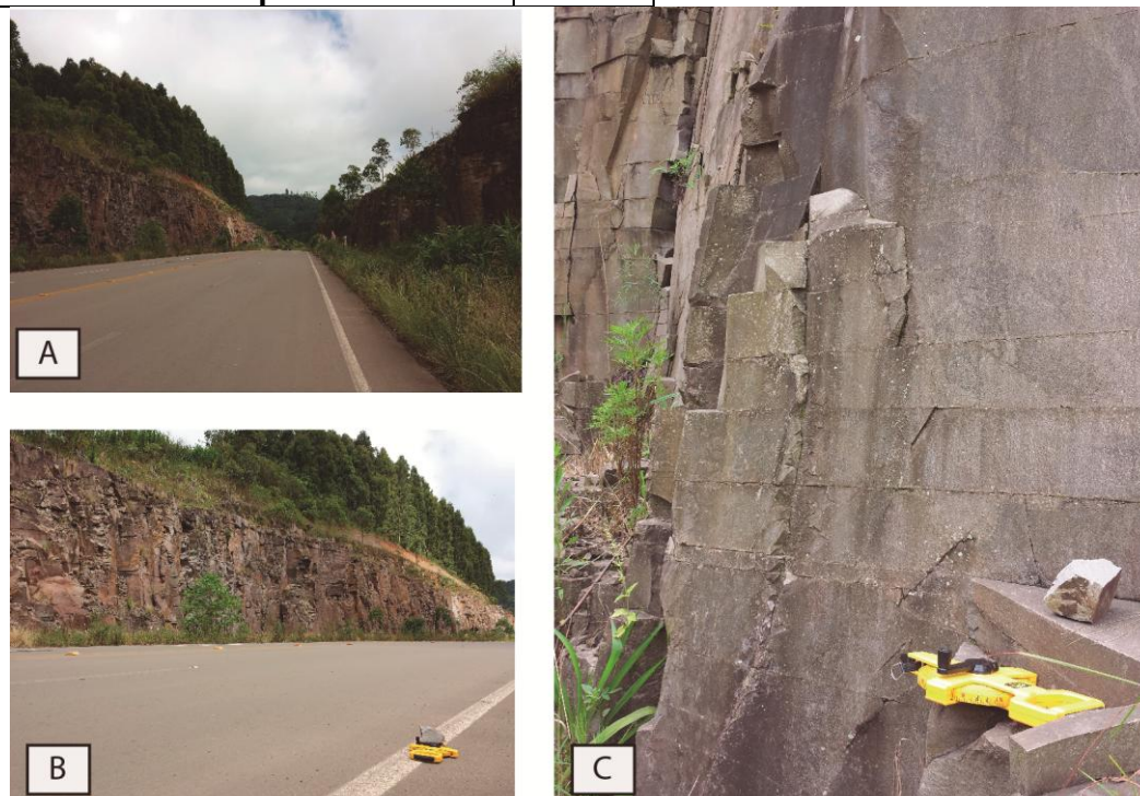
Figura 15: (A) e (B) visão geral dos taludes com direção norte; (C) fraturas horizontais com espaçamento de até 15cm
