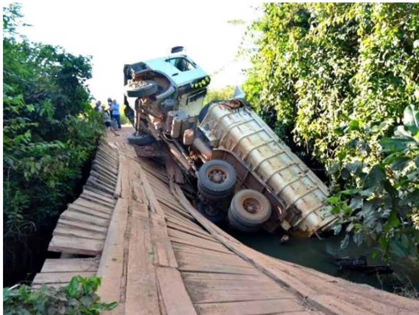
Figura 4 – Foto da falha de um pontilhão de uma estrada secundária
