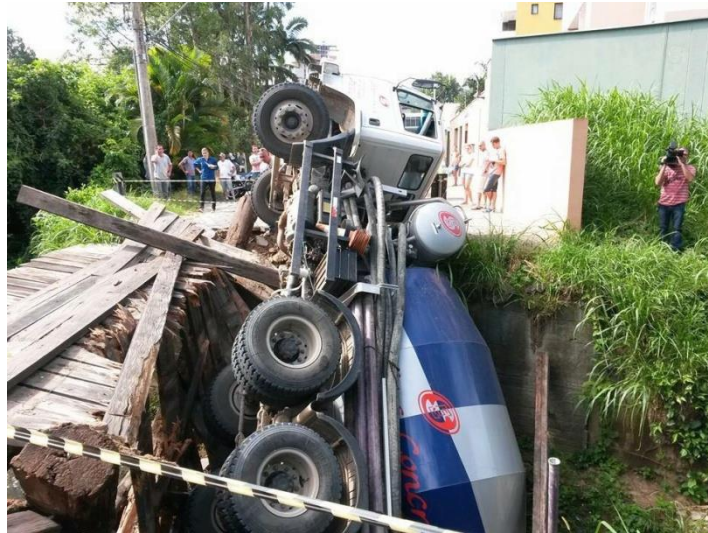
Figura 3 – Foto da destruição parcial do pontilhão do bairro Vila Nova – Blumenau
