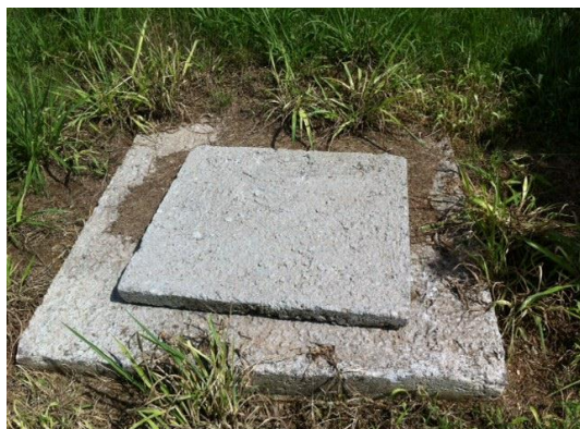
FIGURA 15: Caixa do Ponto 2 - Efluente Tratado (ET). Crédito fotográfico: Renir Bordignon.
