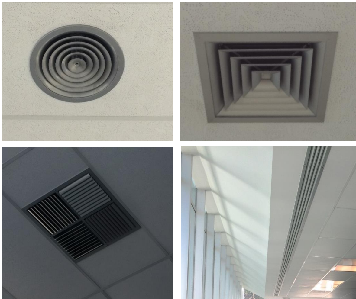
Figura 17 - Saídas de distribuição de ar – difusores
