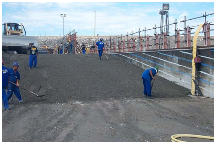
Figura 2.18 : Método rampado; Controle da altura da camada, tem como referência as marcas indicativas pintadas na forma - AHE Peixe Angical - TO (Foto cedida por FURNAS Centrais Elétricas S.A.).
