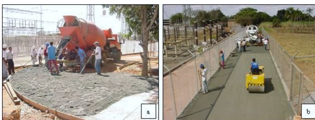
Figura 2.27 : Concretagem experimental de CCR para camada final de pavimento rodoviário, realizada em FURNAS, Aparecida de Goiânia (GO): (a) lançamento do CCR; (b) compactação do CCR (Fotos cedidas por FURNAS Centrais Elétricas S.A.).
