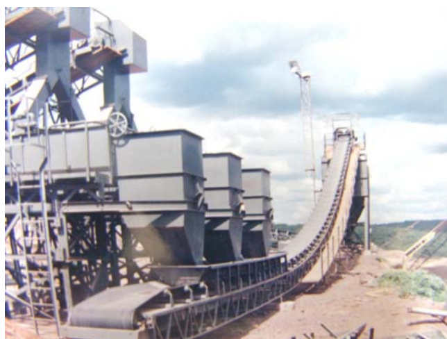
Figura 2.10 : Exemplo de Central de CCR tipo Pug Mill – Utilizada para Dosagem e Mistura do CCR na UHE Capanda - Angola (Foto cedida por FURNAS Centrais Elétricas S.A.).
