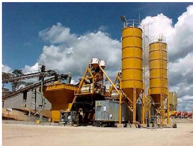
Figura 2.9 : Exemplo de Central gravimétrica de CCR utilizada na construção da UHE Cana Brava – GO.
