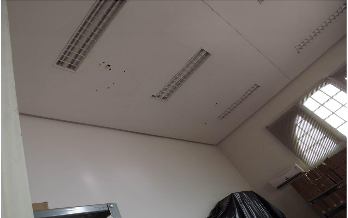
Fotografia 3 - Buracos no forro de gesso causados por temporal
