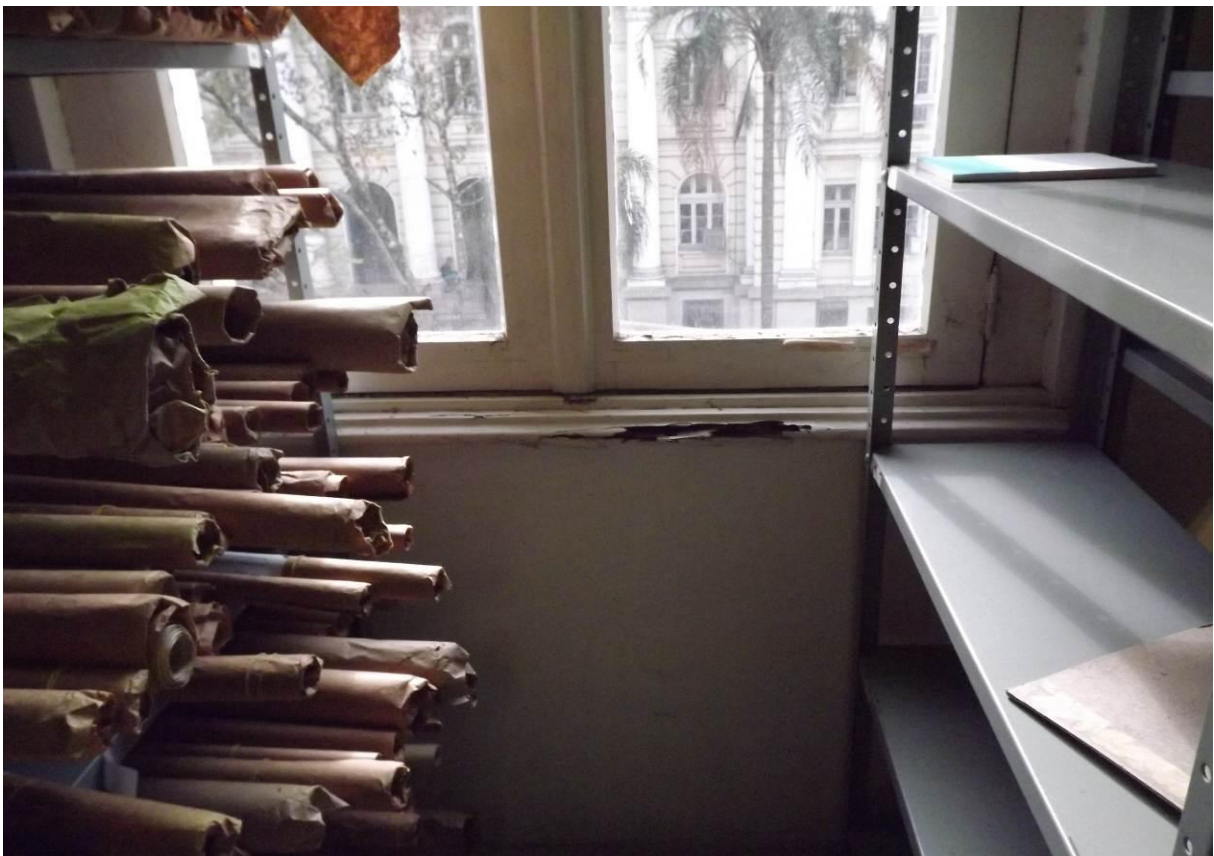
Fotografia 12 – Ação de cupins nas janelas
