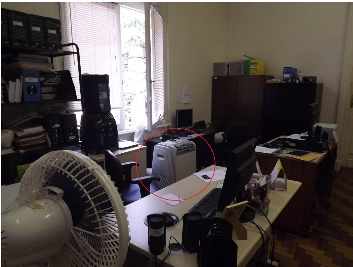
Fotografia 2 – Ar-condicionado da sala dos funcionários
