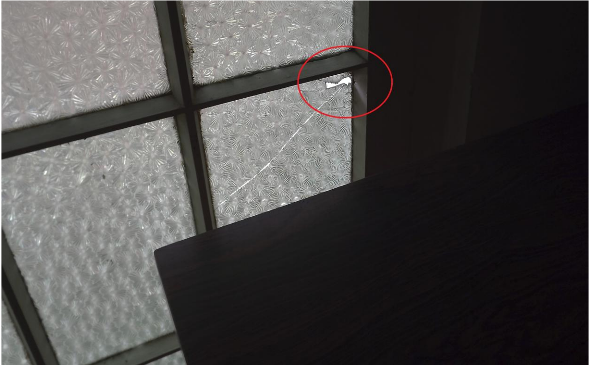
Fotografia 11 – Vidro quebrado no acervo
