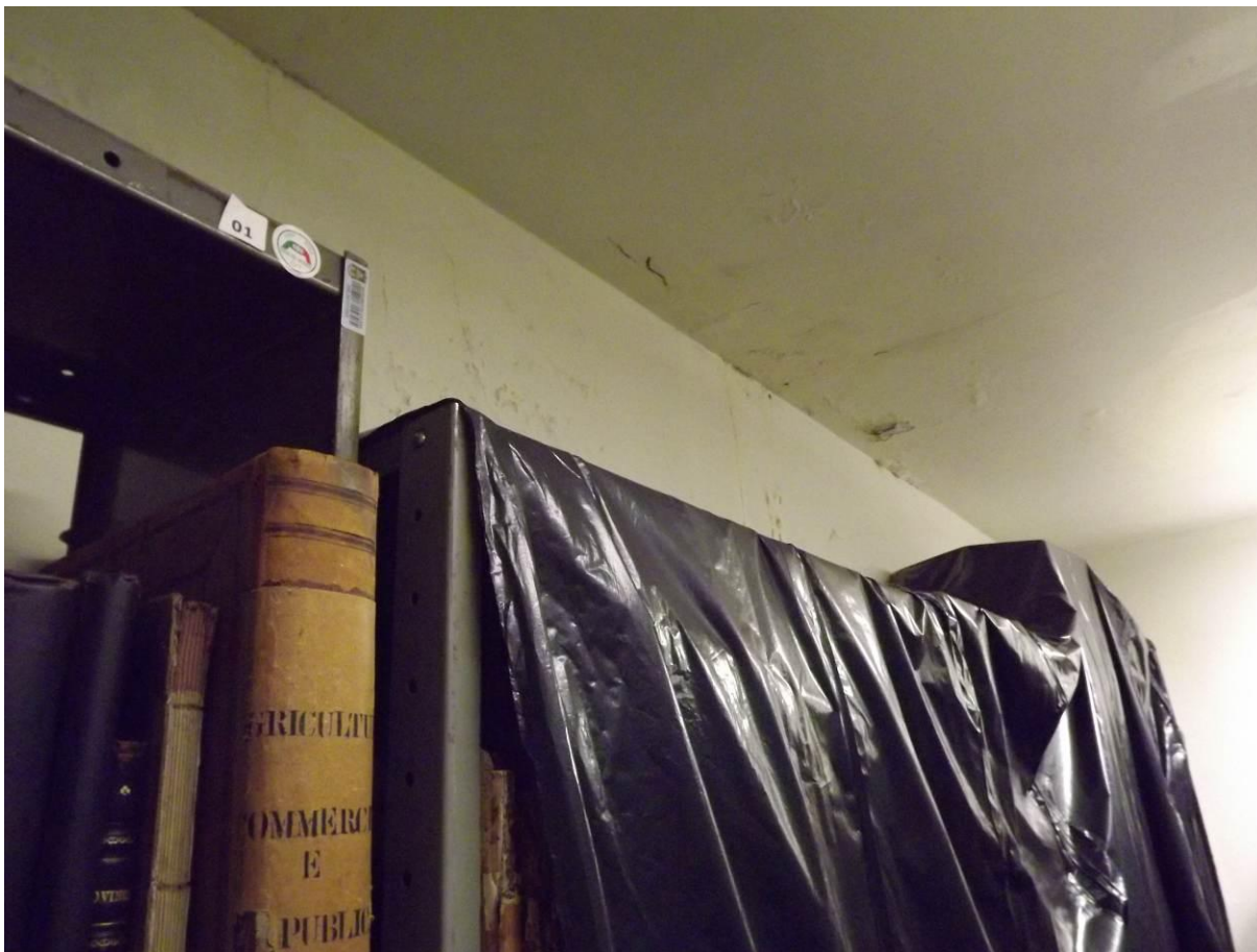
Fotografia 5 – Infiltração nas paredes e teto do acervo
