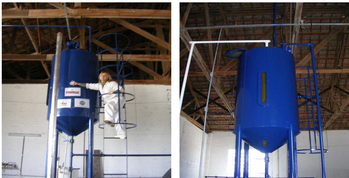
Figura 10. Fotografias do reator da usina-piloto de biodiesel: (a) visão geral do reator/decantador; (b) detalhe dos visores do reator
