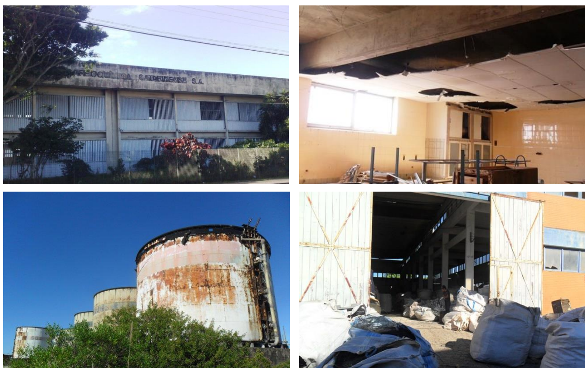
Figura 12: Atual situação da área, construções, tanques deteriorados e resíduos do processo abandonados (Fonte: www.blogpenadigital.com ).
