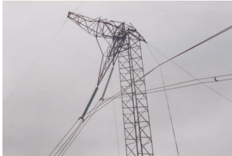
Figura 1. 4 – Braço de uma torre estaiada colapsada produto da diferença de tensões causada por ventos de downburst .
