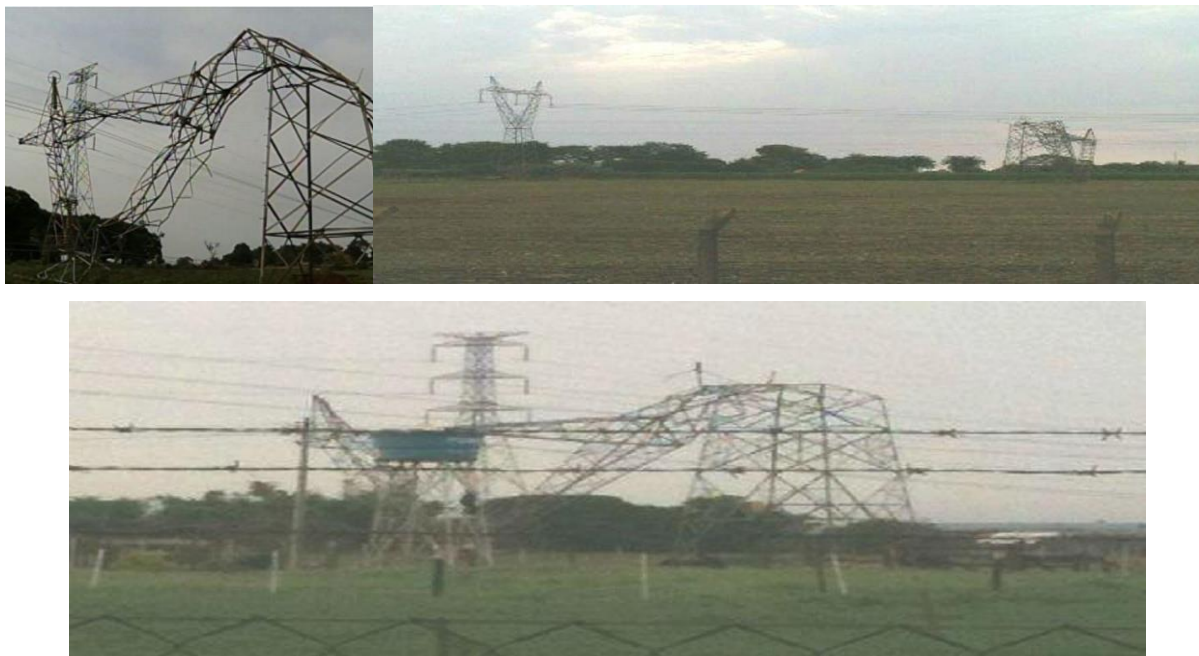
Figura 5. 24– Colpasos de torres de transmissão tipo Delta resgistrados em Cândido Mota, no centro-oeste de São Paulo. Fonte: (DEOLHONOTEMPO, 2012).
