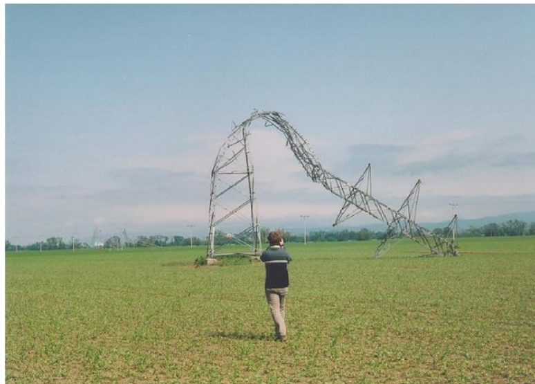
Figura 1. 2 – Exemplo de uma das torres colapsadas . Fonte (KAŇÁK et al., 2007)
