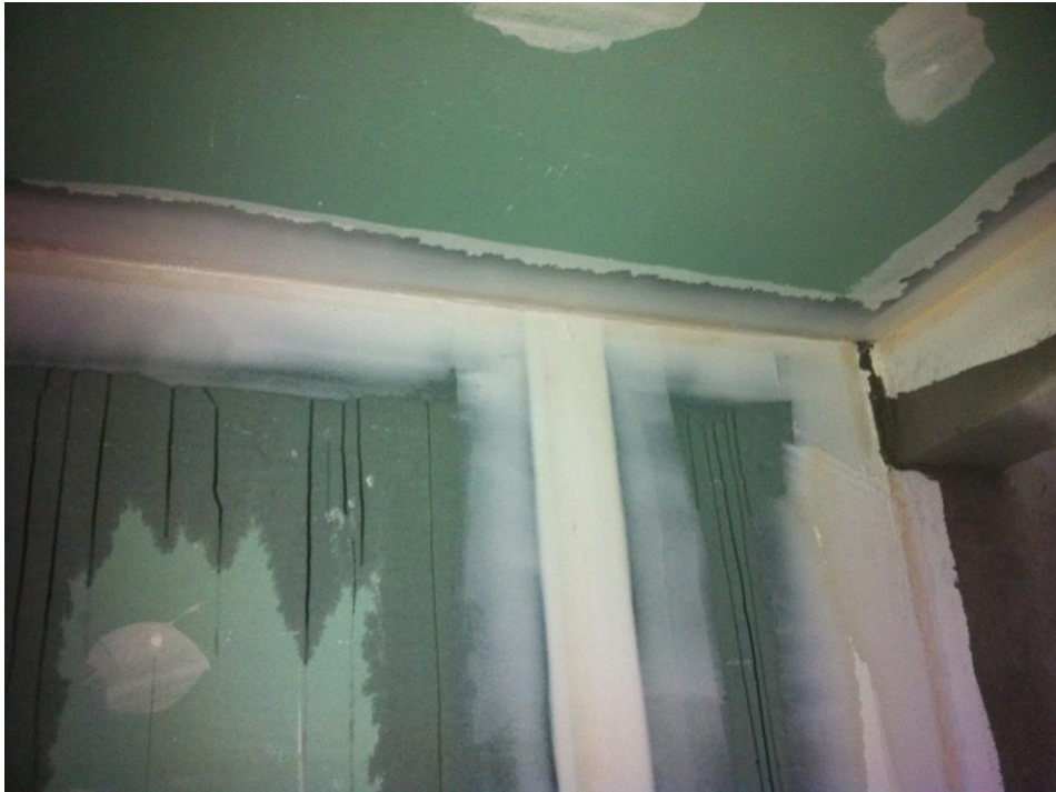
Figura 20 – Danos causados pela umidade
