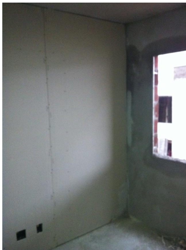
Figura 27 – Umidade nas placas standard
