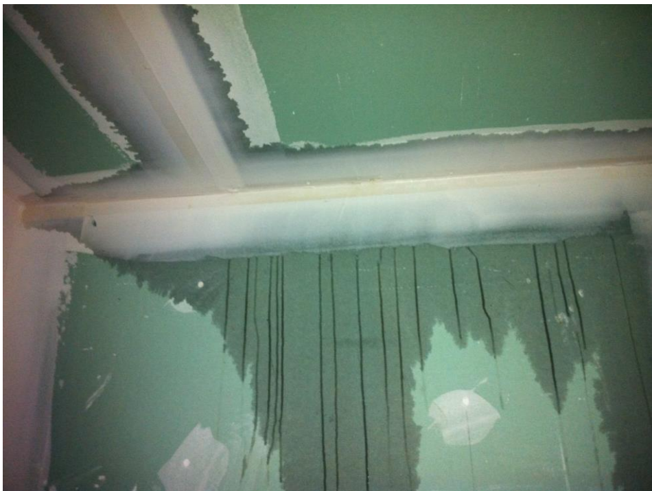
Figura 21 – Danos causados pela umidade
