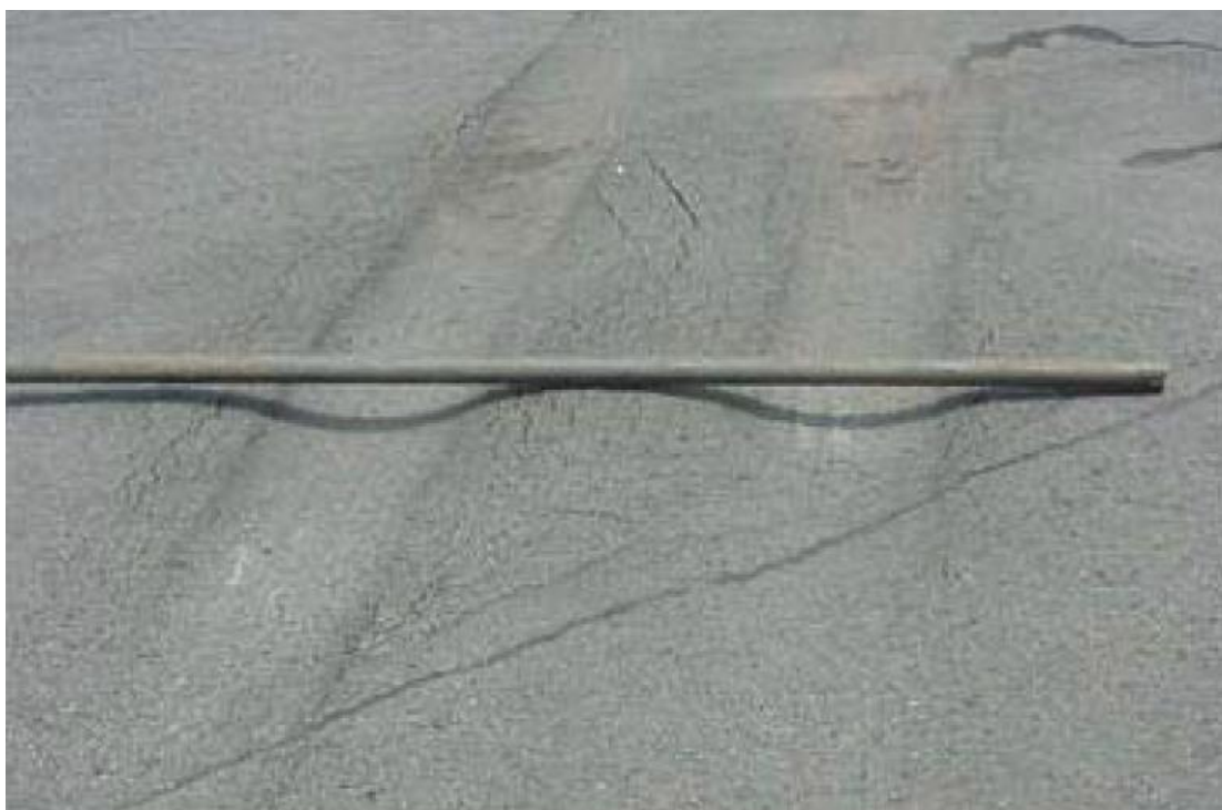
Figura 11 – Deformação permanente no revestimento asfáltico
