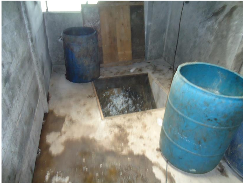
Figura 58: Boca de alimentação no segundo piso que acessa o moinho. Fonte: Arquivo digital CAMP.
