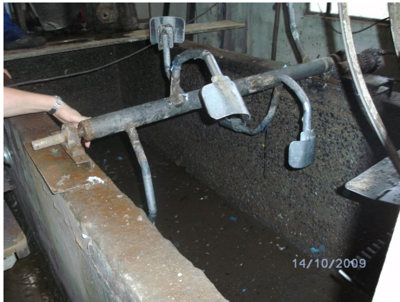
Figura 46: Tanque e equipamento denominado arraste aranha. Fonte: Arquivo digital CAMP.
