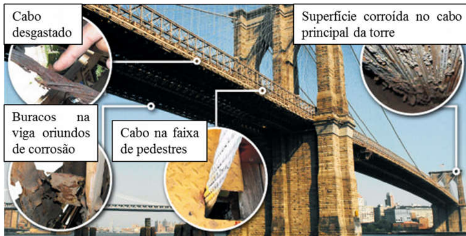
Figura 10 – Cabos de aço corroídos na ponte de Brooklyn, EUA [43].
