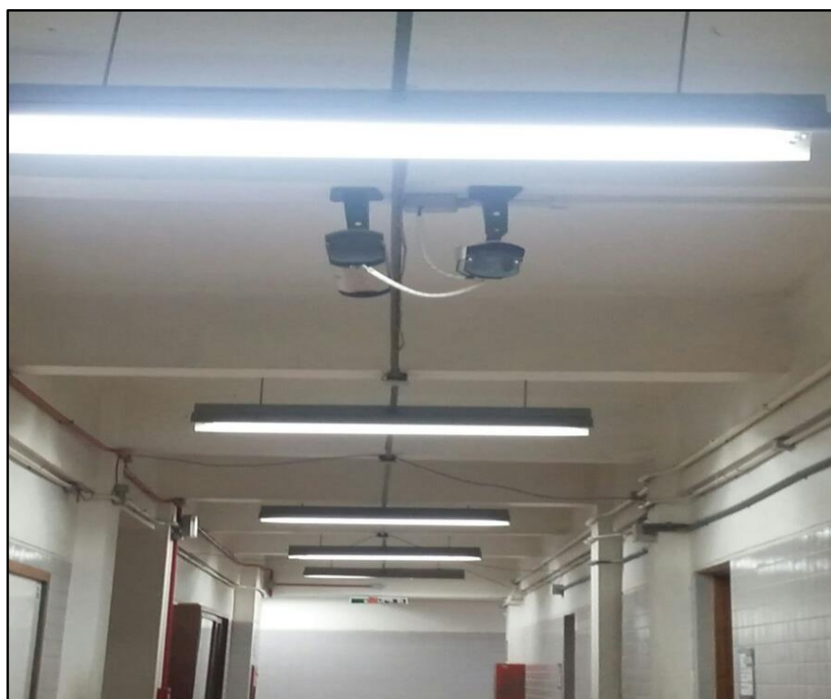
Fotografia 5: câmeras de monitoramento, registrada pelo autor em 12/11/2015
