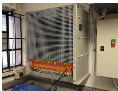
Figura 15: Banco de resistores
