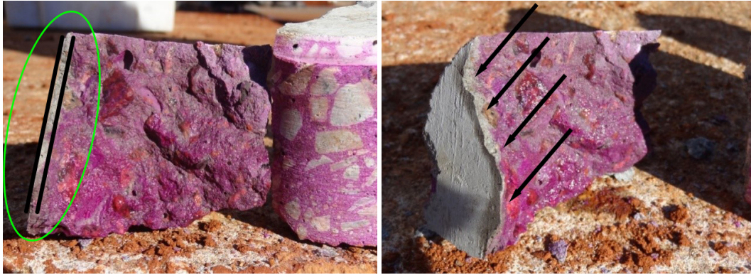
Figura 12: Ensaio de carbonatação de uma das amostras de concreto extraídas.
